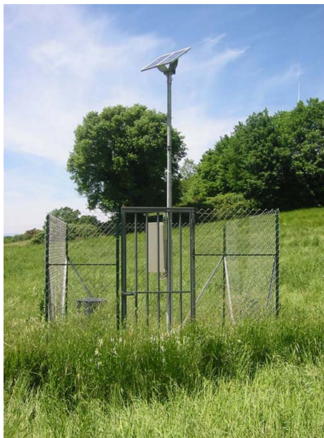
Stazione piezometrica per la misura dei livelli di falda
