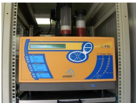
Fig 3 : Analizzatori in continuo installati
