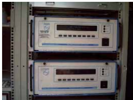
Fig.7 Analizzatori in continuo
