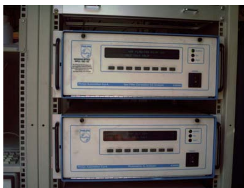
Fig.7 Analizzatori in continuo
