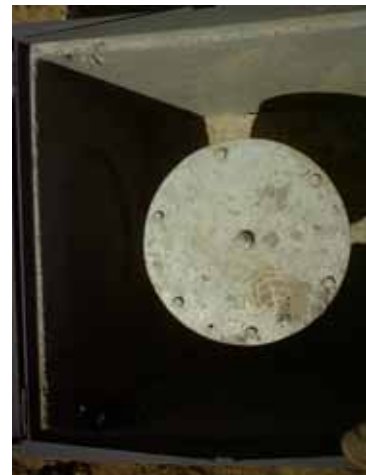
Figura 4 – Particolare del boccapozzo e della sonda idrostatica.
